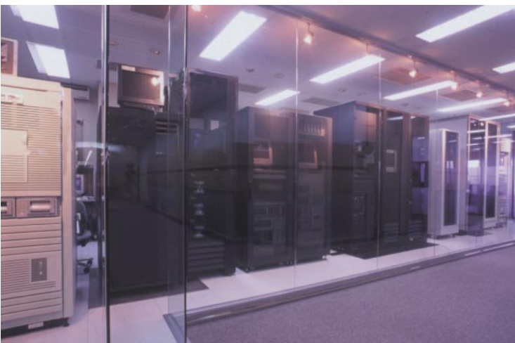
検証システムが設置されたプライスウォーターハウスクーパース コンサルタントのマシンルーム
